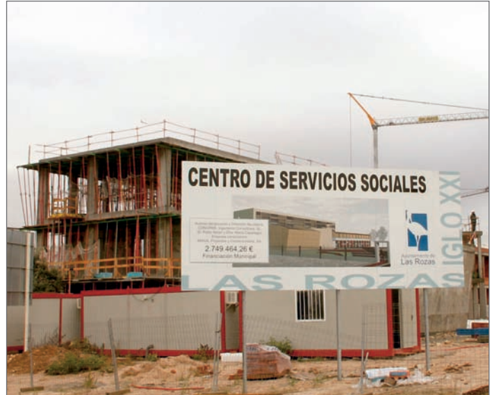
En la imagen, las obras del nuevo Centro de Atención Social hace un mes
